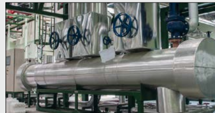
CLIMATISATION RÉFRIGÉRATION CONDITIONNEMENT D'AIR
